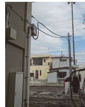
高圧受変電設備が利用できないため、校外の電線より低圧電力を引き込み、仮設電源として利用
