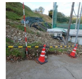
土砂崩れに対する立入禁止措置
