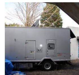
電源車の配備
